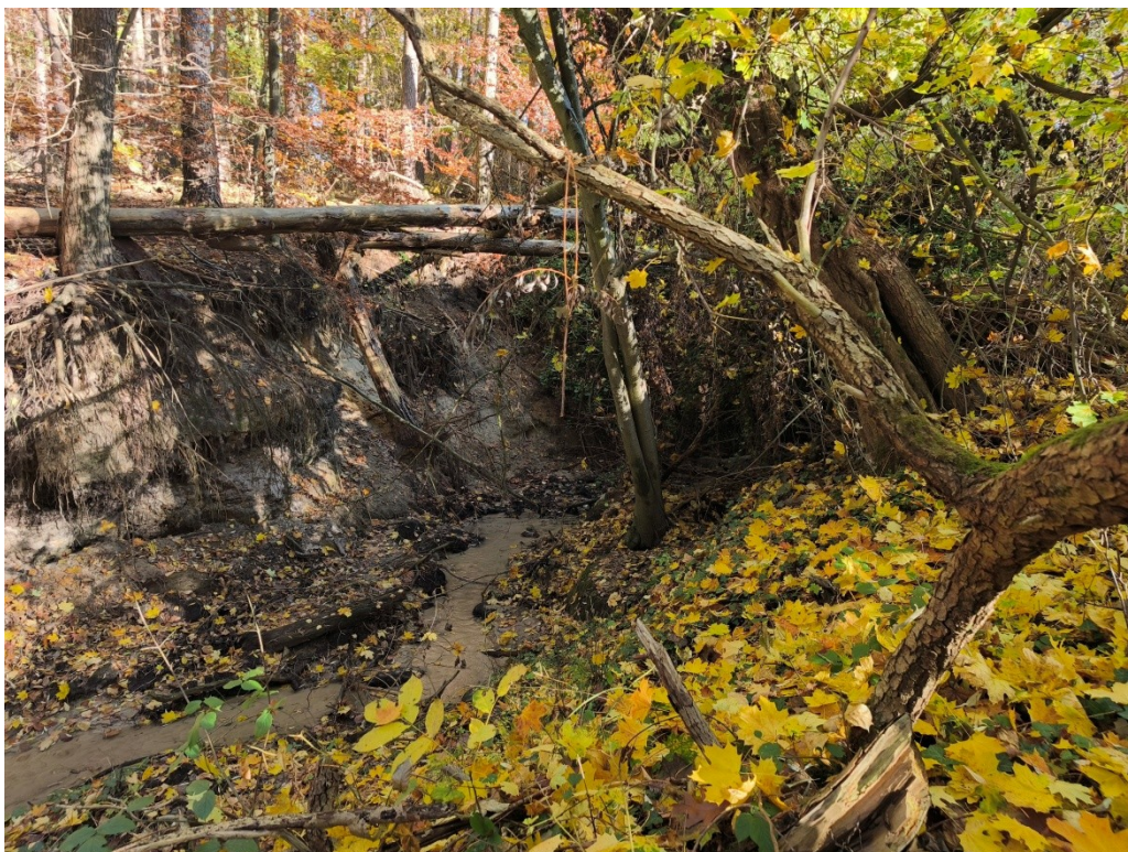
Fot. 3. Dolna część poniżej osuwiska – zniszczone i zaciśnięte koryto potoku.
